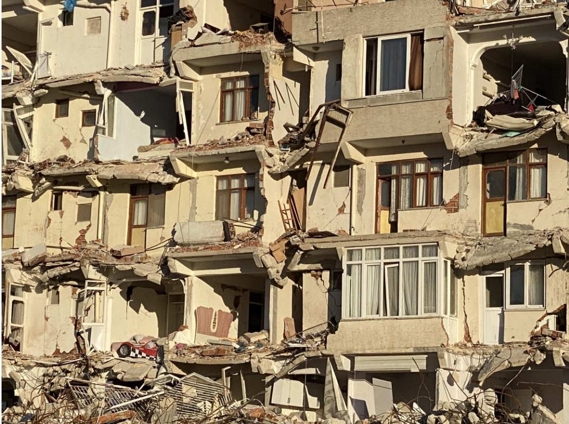
Hatay'ın Defne ilçesinde enkaz halinde bir bina. Uluslararası Af Örgütü araştırmacıları, depremlerden en ağır etkilenen illerden biri olan Hatay'da meydana gelen hasarı ve yerinden edilme koşullarını inceledi. © Uluslararası Af Örgütü
